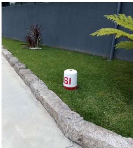
Figura 23 – Marco de incêndio no interior do recinto
