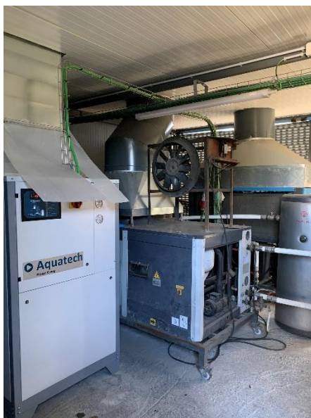
Figura 16 – Equipamento de refrigeração
